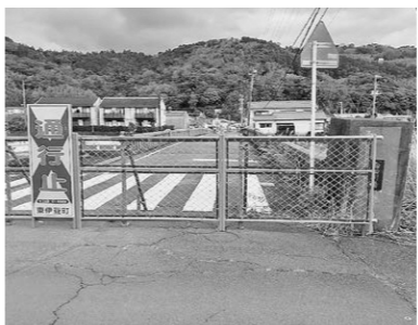
通行止めが一年続く白田川橋
