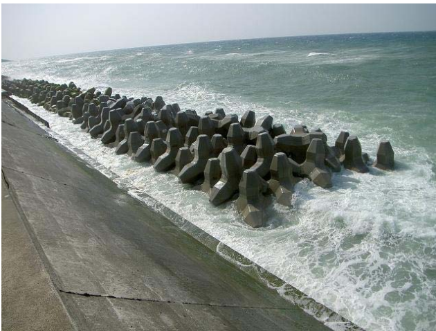
ねがためこう 根固工により防潮堤を保護 (御前崎市白羽の海岸防災林地内)
