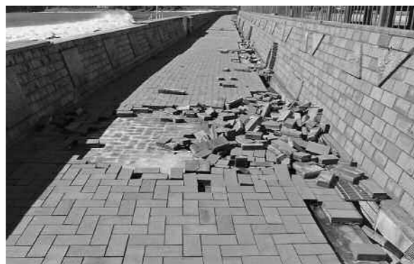
高波により歩道ブロックが破損 ～池尻海岸～
