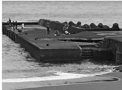
高波による堤防の一部損壊 ～熱川海岸～
