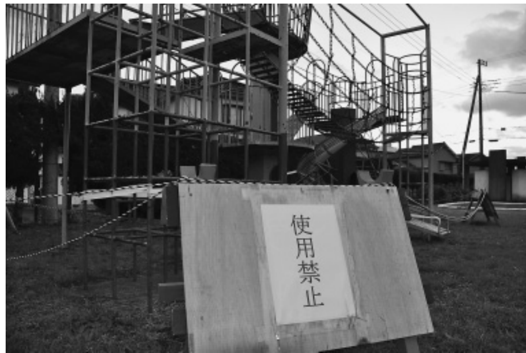
不具合のある遊具は使用禁止にしている ～片瀬の都市公園内にある遊具～
