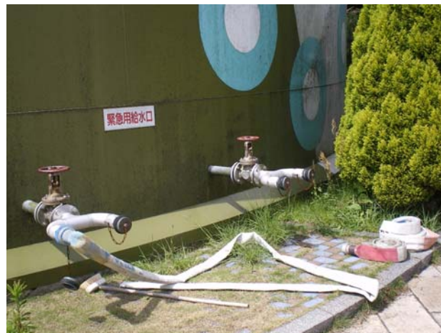
図4 新稲取配水池の緊急用給水口
